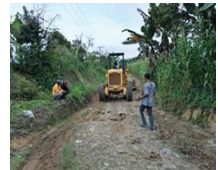
Sewa alat berat untuk perbaikan jalan Dusun XIII Pardomuan Nauli Desa Tangga Batu Kecamatan Hatonduhan
